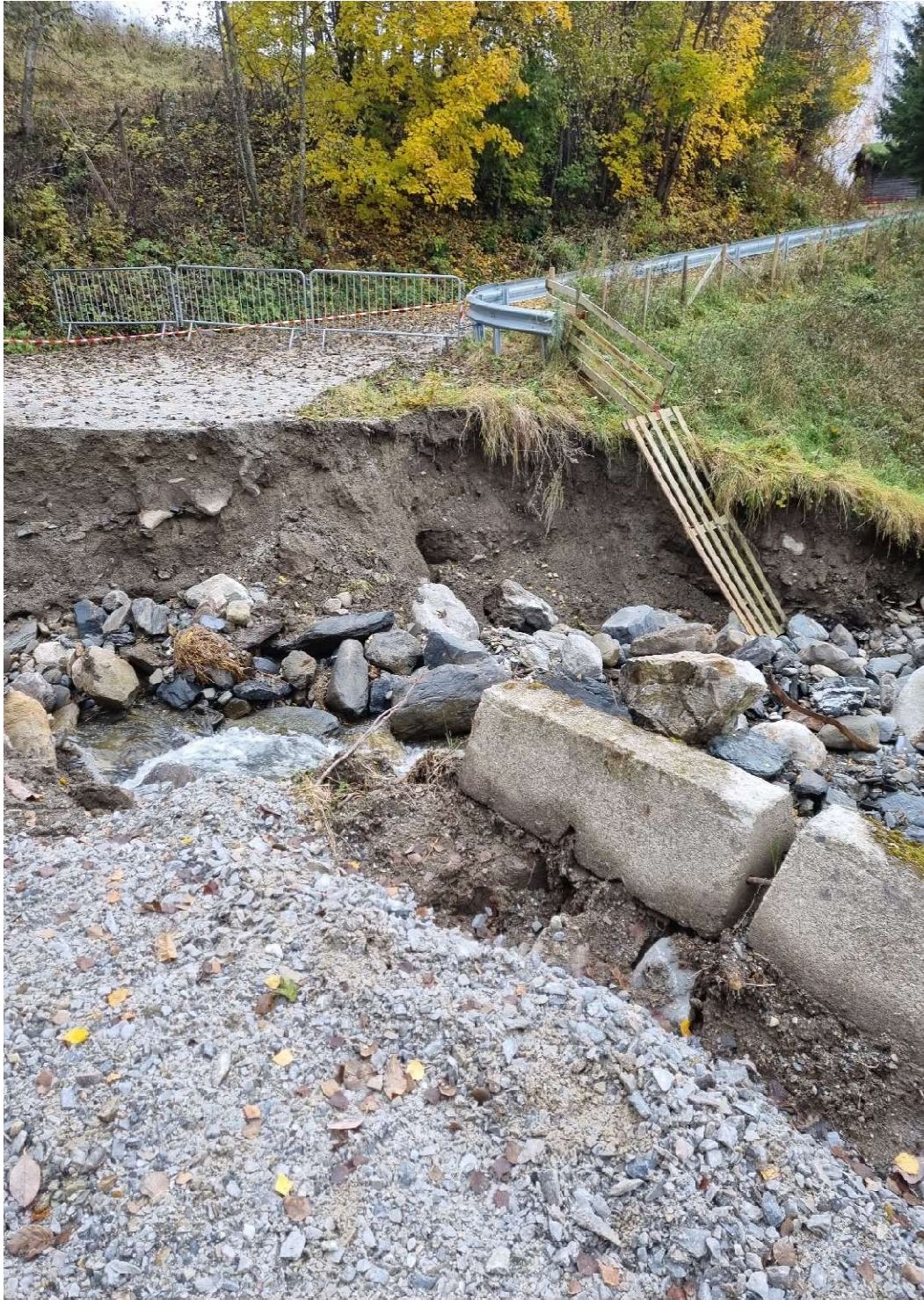
Figur 6: Bilde 2: Kulvert i Thujordsvegen har blitt vasket bort. Viktig at ny sikring samstemmer med ny kulvert Foto: NVE 16.10.24.
