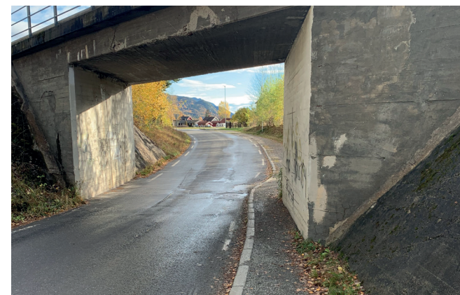
Kryssing av jernbanen i øst er en uholdbar løsning for myke trafikanter, men også en dårlig løsning for biltrafikken, og særlig tungtrafikk
