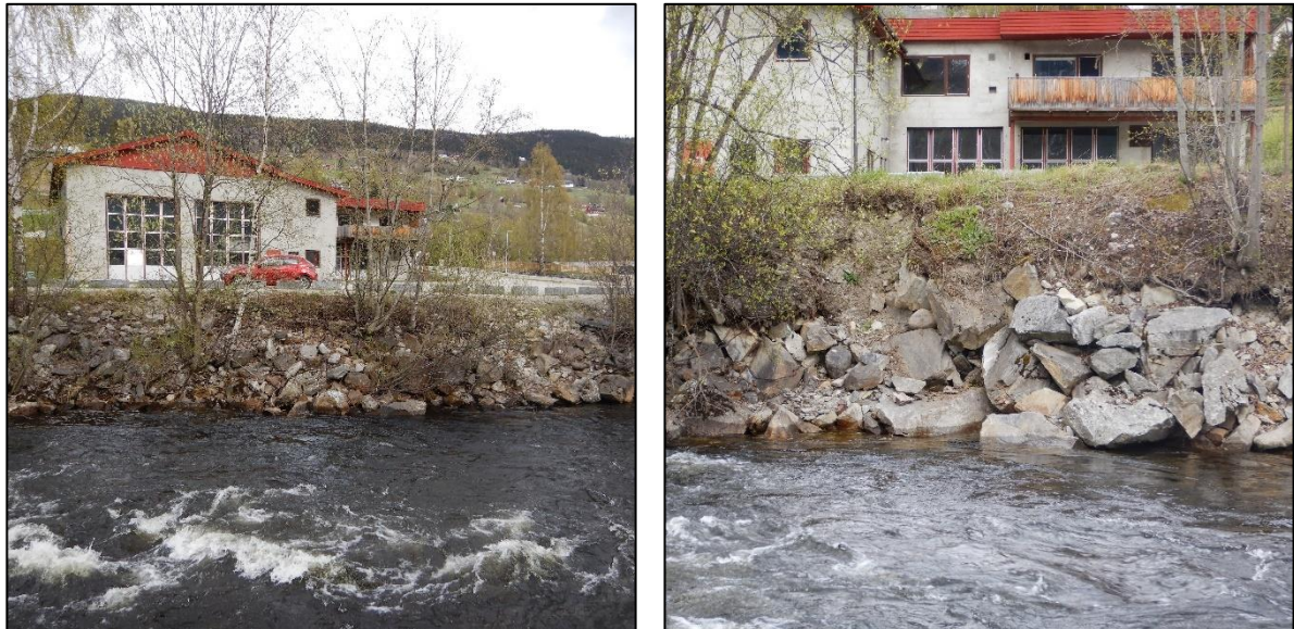
Figur 4: Karakteristiske bilder av elvekant mot planområdet som viser manglende og skader på erosjonssikring.
