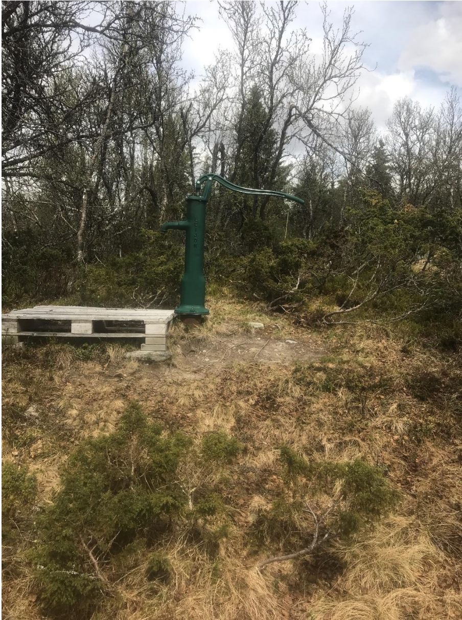
Bilde 1: Viser den håndholdte brønnpumpen som befinner seg i den øvre delen av planområdet.
