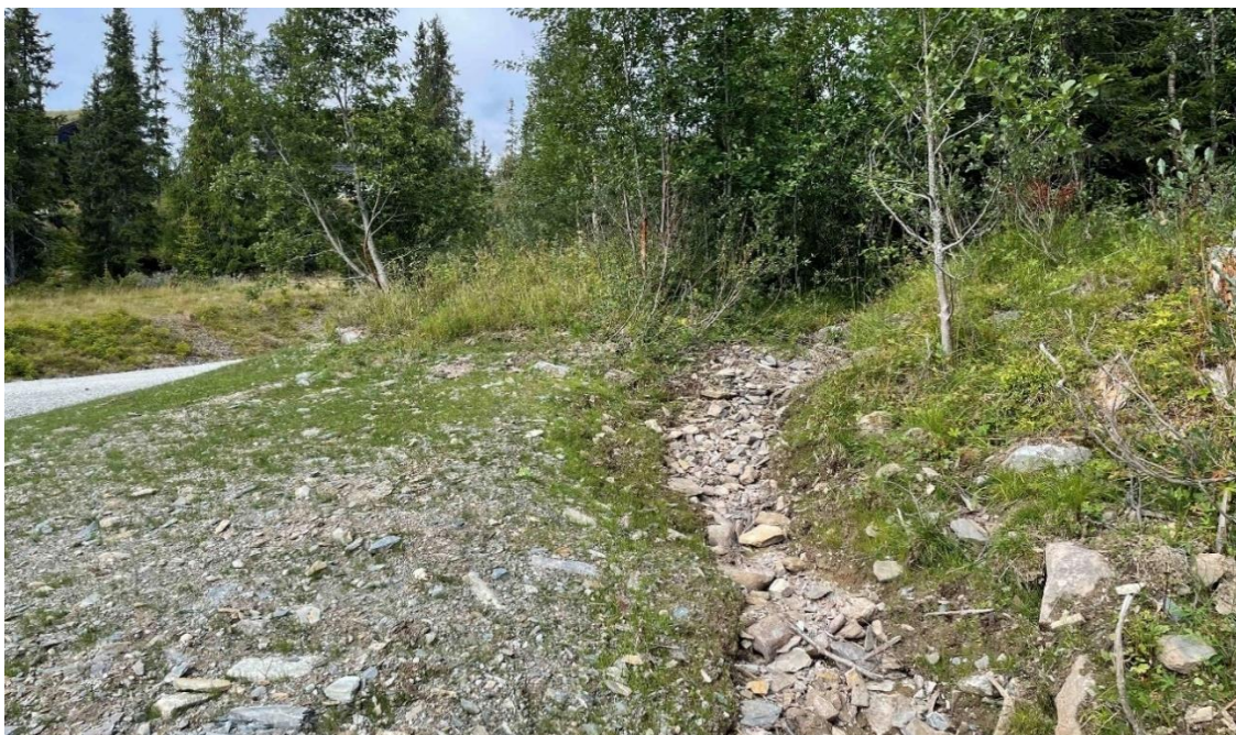
FIGUR 7 NYETABLERT GRØFT SØRVEST I PLANOMRÅDET LEDER BORT OVERVANN FRA PLANOMRÅDET
